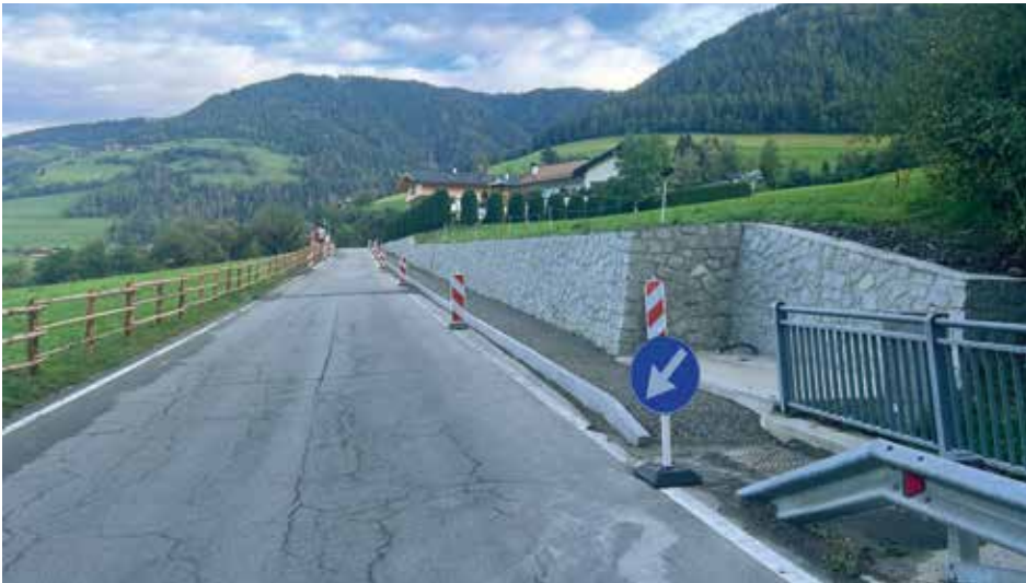
Die Landesstraße beim Balbeinhof wurde verbreitert, ein Gehsteig und eine überdachte Bushaltestelle errichtet
