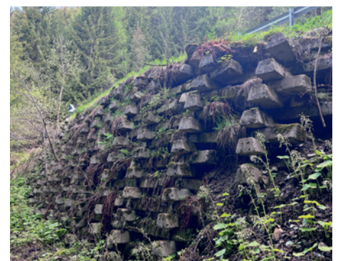
Sanierungsbedürftiger Straßenunterbau in der Kehre oberhalb Löchlerhof
