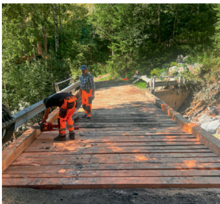
In Rekordzeit wurde die Gschlierer Brücke nach dem Unwetter vom 15. August erneuert
