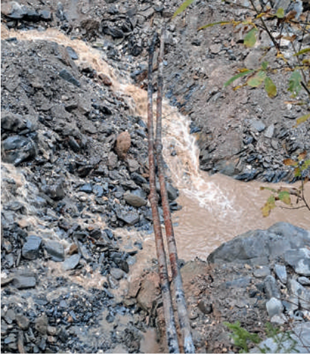
Schritt für Schritt wurden alle beschädigten Stellen am Leitungsnetz geortet und repariert
