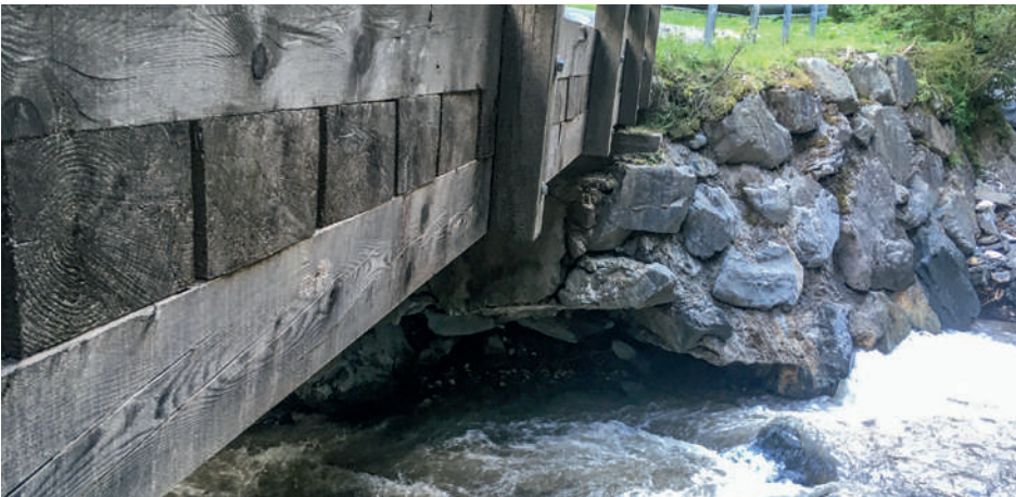
Die Straßensperre zum Würzjoch wurde von einigen kritisiert, war bei genauerem Hinschauen jedoch unabdingbar: Fundamente von Brücken und Straßen waren völlig unterspült und hingen in der Luft
