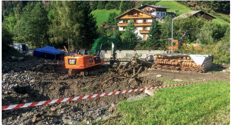
Am Tag nach dem Unwetter begann das große Aufräumen: Mit schwerem Gerät wurde versucht, die Wasser- und Stromversorgung wiederherzustellen sowie die Bäche und Gräben freizulegen
