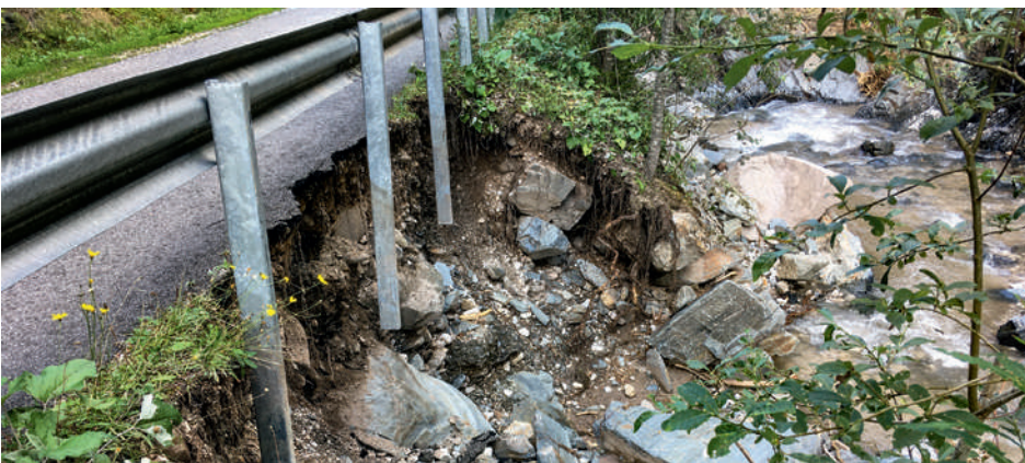
Bei den Lokalausganscheinern ermittelten die Techniker alleine auf der Strecke Schmiedbrücke bis Gunggan 70 Stellen, an denen dringende Sicherungsmaßnahmen erforderlich sind
