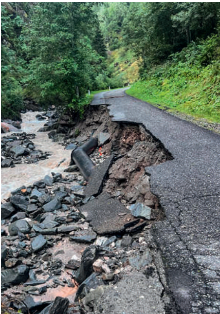
Die Druckleitung zum E-Werk wurde freigelegt und beschädigt
