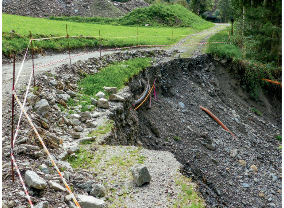
Auf der Strecke des alten Petschieder Weges fraß der Bach große Lücken in den Weg und legte Strom- und Glasfaserleitungen frei
