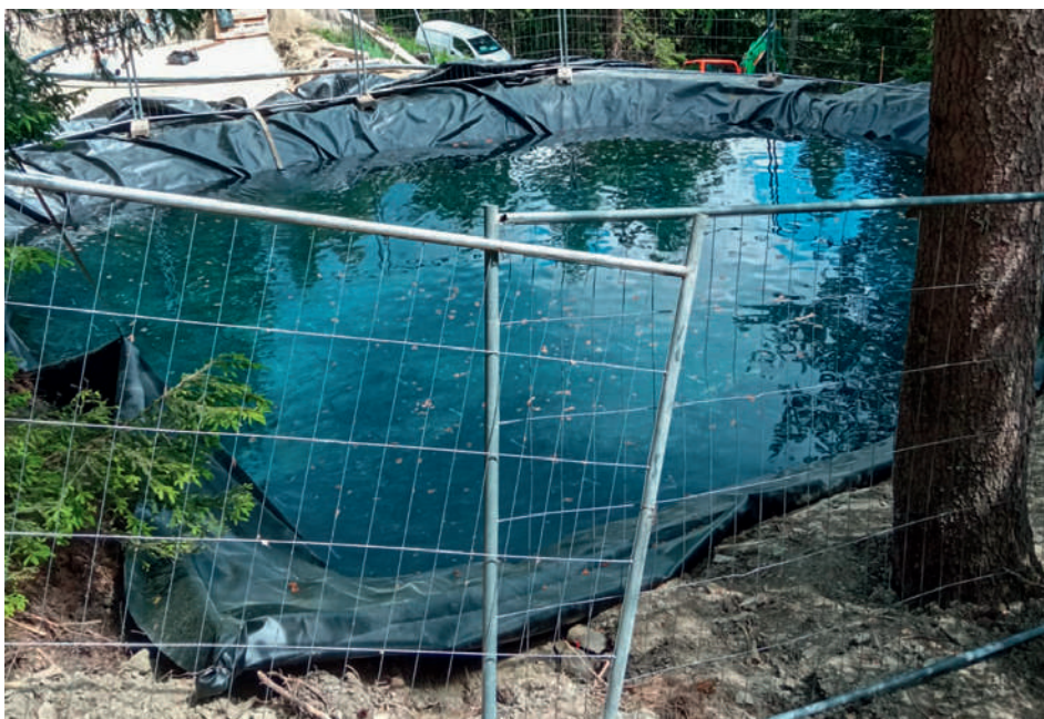
Der provisorische Löschwasserspeicher, der während den Sanierungsarbeiten am Hochbehälter angelegt wurde
